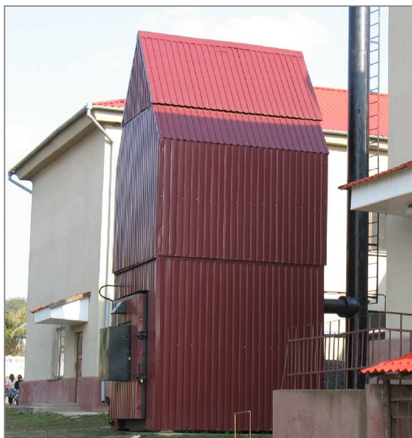
Система отопления на биомассе (котлы на соломенных брикетах), установленная в школе села Тараклия района Кэушень.
