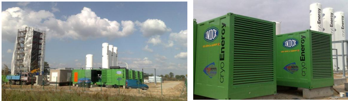
Views of the Poznan LNG plant
