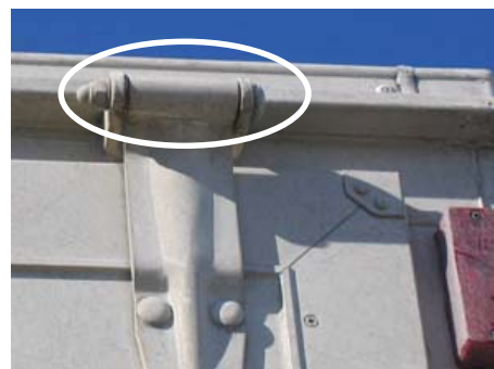
C. Charnière non sécurisée retenant le panneau en bois. La tige est simplement un boulon ordinaire avec un écrou en forme de dôme, non soudé.
