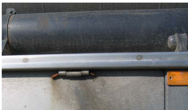
D. Inspecter les charnières. La tige de cette charnière a été remplacée par un morceau de barre de fer rouillé, qui n'offre aucune sécurité.
