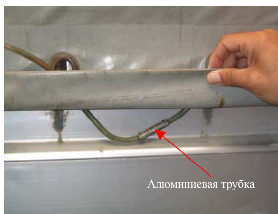
Д: Соединенный трос МДП - используется кусочек алюминиевой трубки.
