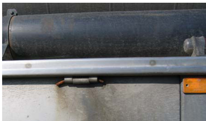
Д: Осмотр петель. Ось данной петли была заменена куском проржавевшего железного стержня без какого-либо закрепления.
