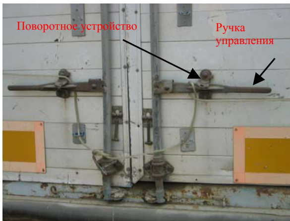
А: Слишком длинный трос МДП: ручка управления не закреплена. Трос даже не проходит через отверстие в поворотном устройстве и ручке.
