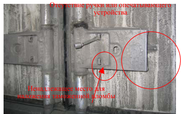
В: Отсутствие ручки и печатающего устройства справа: неправильное наложение пломбы.
