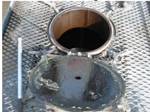
Abb. 4: Fehlende Dichtung bei einem Mannlochdeckel
