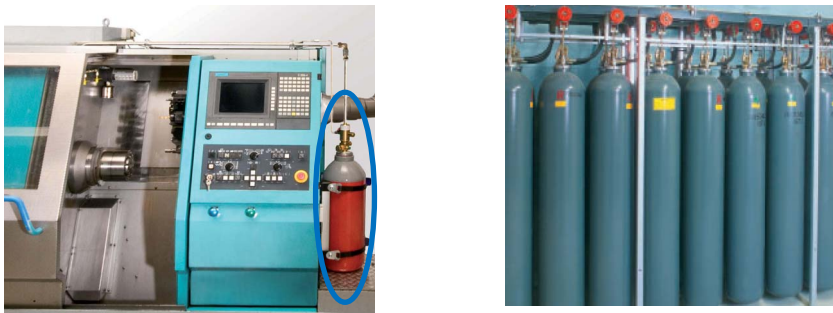
Illustrations 4 et 5: Bouteilles à gaz utilisées dans les installations d'extinction d'incendie
