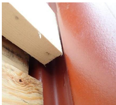
Figure 7.72 – Poutre trop courte
